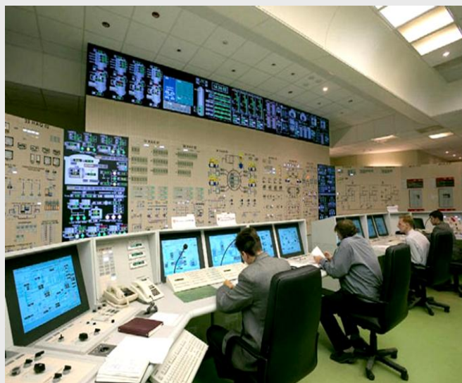
БЛОЧНЫЙ ЩИТ 3 ЭНЕРГОБЛОКА КАЛИНИНСКОЙ АЭС
